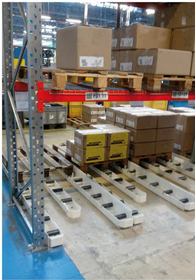
Rails au sol sous un rayonnage à palettes avec butée anti-retour.
