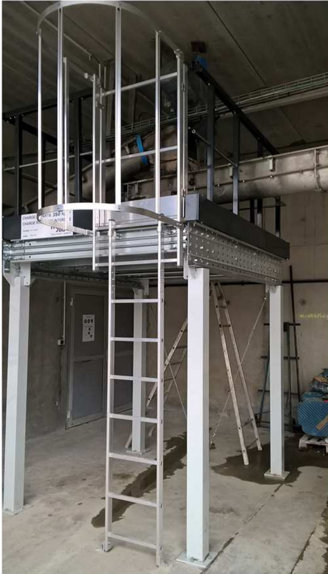
Plateforme avec échelle à crinoline.
