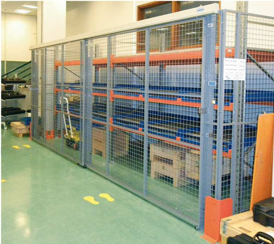
Mise en sécurité d'un rayonnage à palettes par 2 portes coulissantes grillagées.
