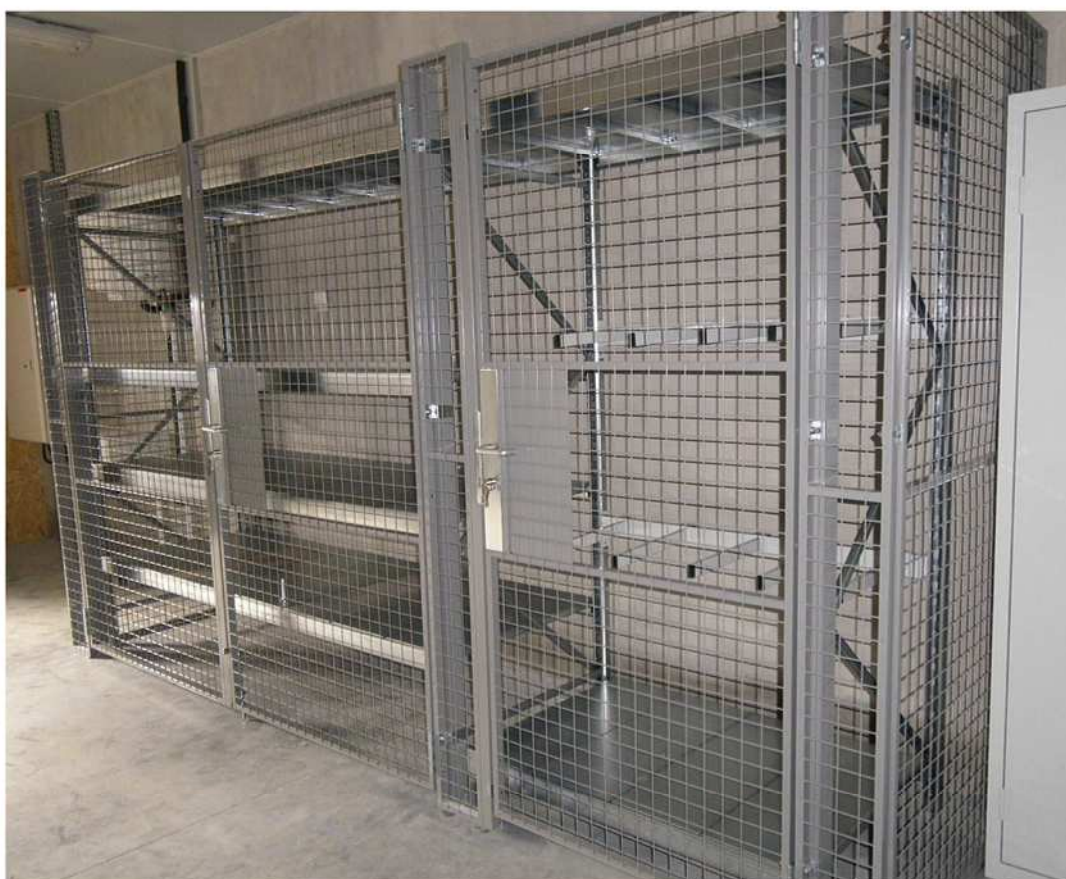
Mise en sécurité d'un stockage vertical par portes battantes à serrure.
